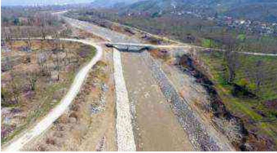
Şekil 1. 30. Düzce İli derelerindeki taşkın koruma tesisi örnekleri (Uğursuyu Deresi)
